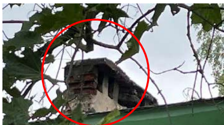
разрушенный оголовок дымовых и вентиляционных каналов
